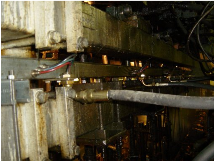
Druckrohrverzweigung des PC 24/7 mit Messschlaucheinheit für jede Station
